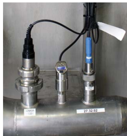
Die Memosens-Sensoren Oxymax COS61D und Orbisint CPS11D überwachen Sauerstoff- bzw. pH-Werte direkt im SBR (Mitte: Ceraphant T PTC31 Druckschalter)
