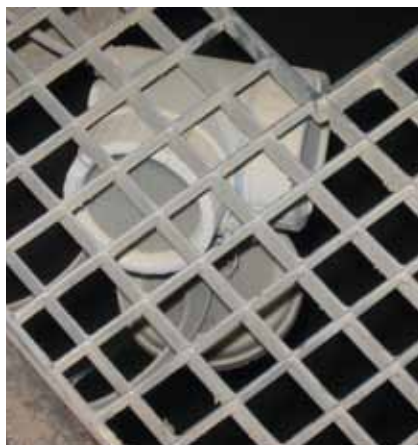
Pour réduire le risque d'obstruction, le Micropilot FMR56 est installé dans la cellule de malt
