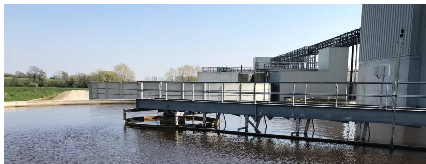
Installation de traitement des eaux usées à l'usine Pasfrost de Passendale, en Belgique
