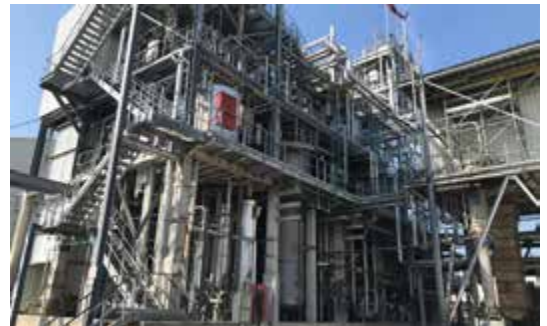
Gaswäscher im Werk von Proviron in Ostende, Belgien
