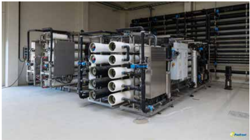
Umkehrosmoseanlage im Werk von Pasfrost.
