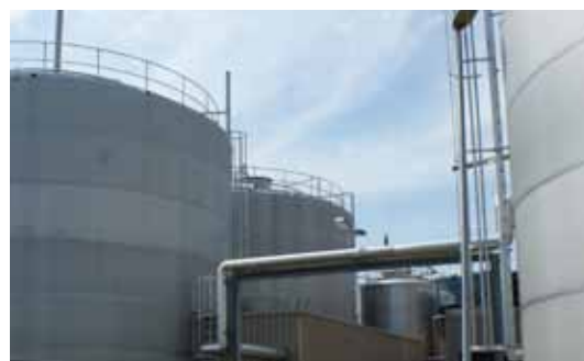
Traitement durable des eaux usées dans l'usine de transformation laitière d'Emmi à Dagmersellen, en Suisse
