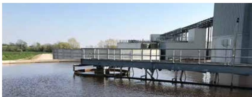
Kläranlage im Werk von Pasfrost in Passendale, Belgien
