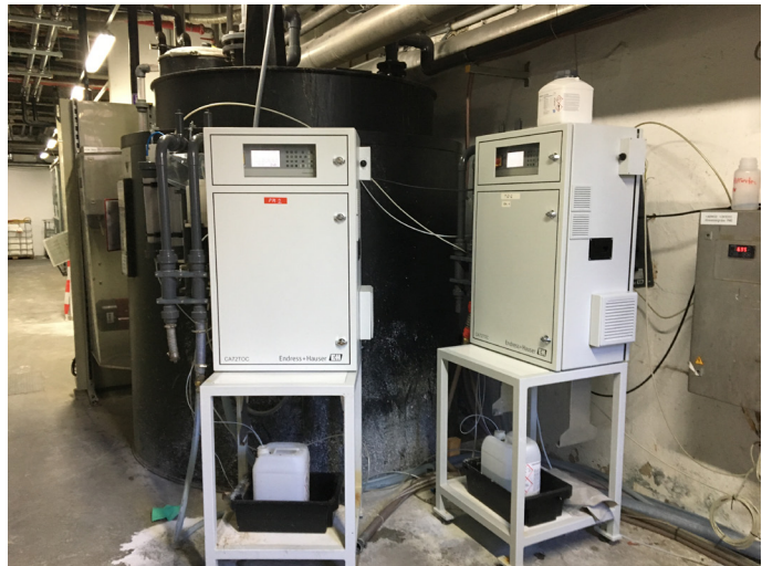
Die beiden CA72TOC Analytoren im Ablauf der biologischen Abwasserreinigung.
