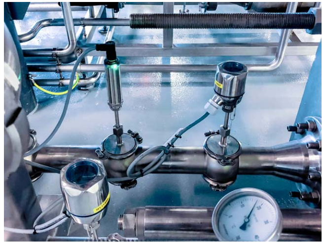
Installierter Sensor iTHERM TrustSens in der Brauerei
